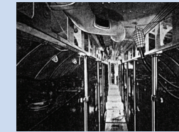
Salle des accumulateurs.
